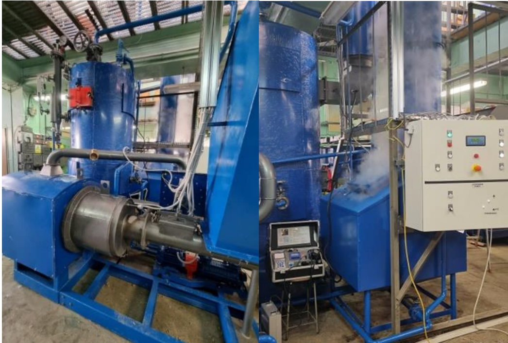
Rysunek 3. Instalacja pilotażowa o wydajności 50 kg/h do torfikacji biomasy drzewnej i biomasy rolniczej w parze przegrzanej opracowana w ramach projektu Lider IX – BIOCARBON.
